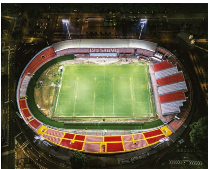
L'OPERA REALIZZATA DA TEA RETELUCE HA VISTO LA FORNITURA E L'INSTALLAZIONE DI 128 PROIETTORI A LED DA 1.700W, RESA CROMATICA CRI 80, SUDDIVISI FRA 112 PER LE 4 TORRI FARO PRESENTI E 16 SULLA COPERTURA DELLA TRIBUNA
